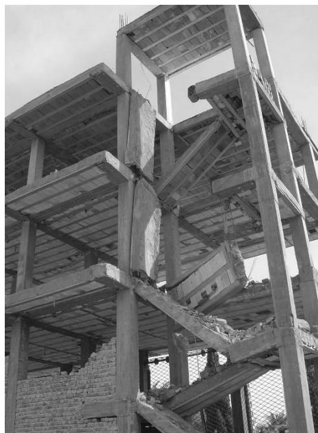
شكل ۱: صدمات وارده بر پله ساختمان هاي بتني
