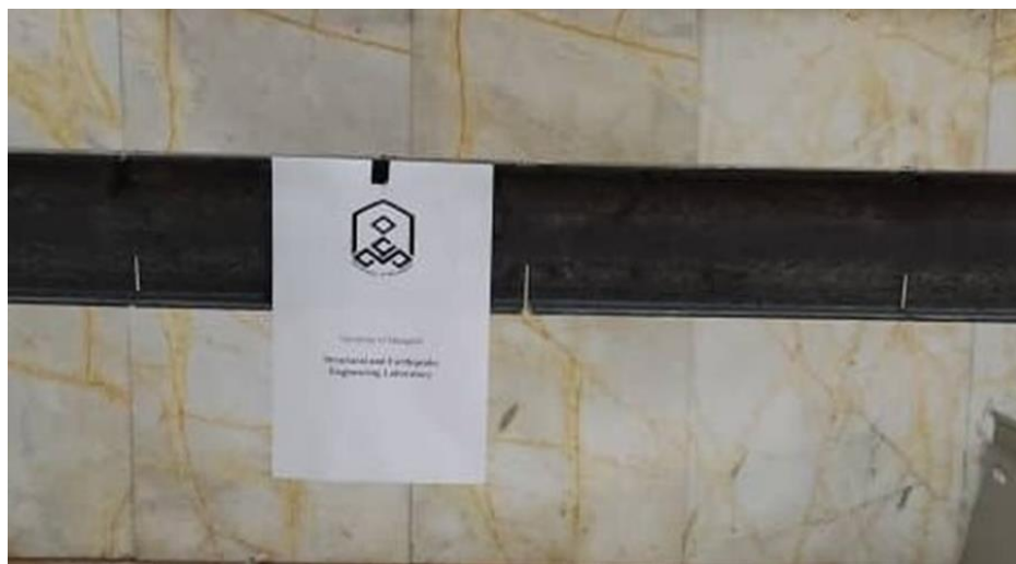
شکل ۵. نمایی از آسیب‌های ایجاد شده در تیر فولادی
