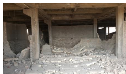
شکل ۲. تخریب میانقاب‌ها در زلزله سرپل ذهاب [6]
