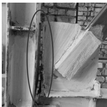
شکل ۱۶: عدم اتصال گاست پلیت به ستون
