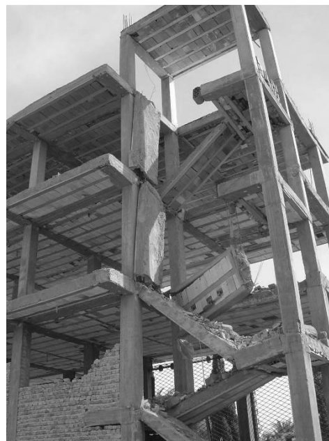
شكل ۱: صدمات وارده بر پله ساختمان هاي بتني
