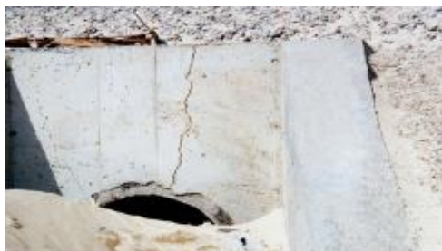
شکل (3) تخریب پل و مسدود شدن دهانه (صلبیت روسازی)
